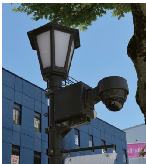
[街路灯に設置した防犯カメラ]
